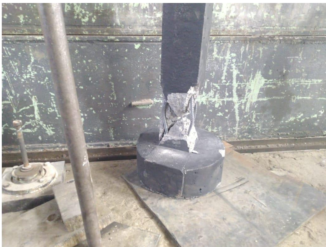
Фото №4 разрушенная свая
