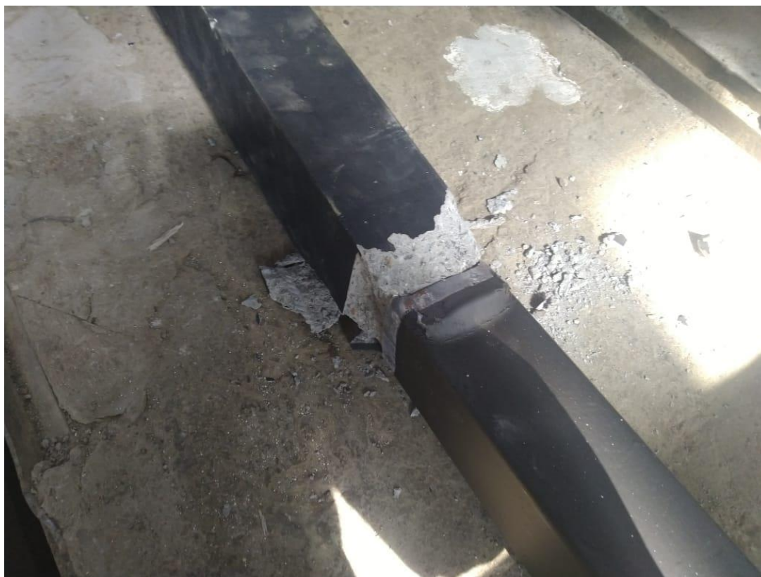
Фото №3 разрушенная свая
